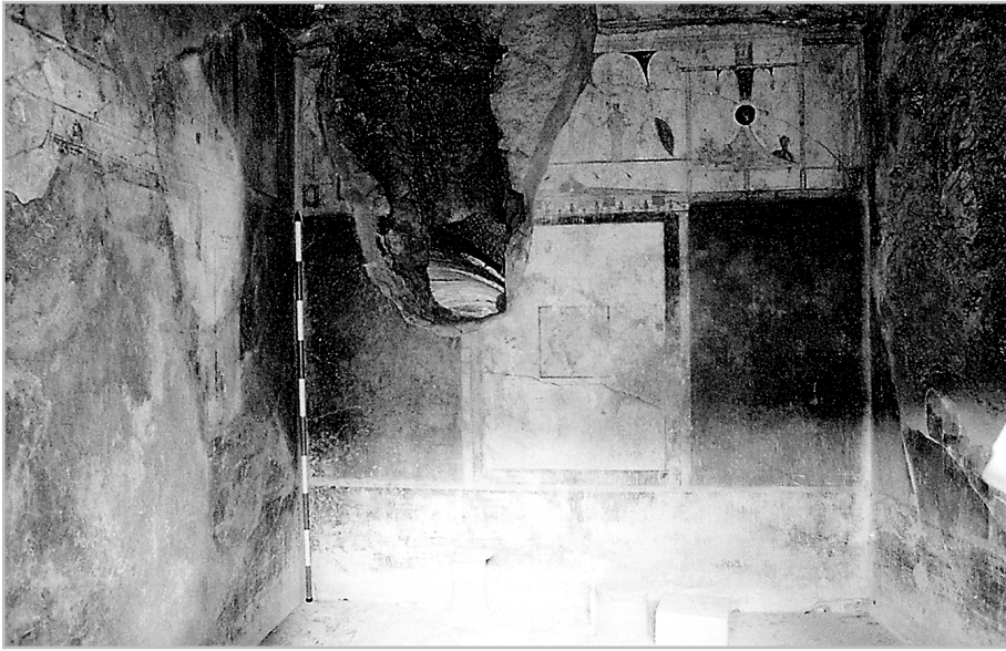
Figure 8.3 Hole in east wall of room f, Casa dei Ceii.
