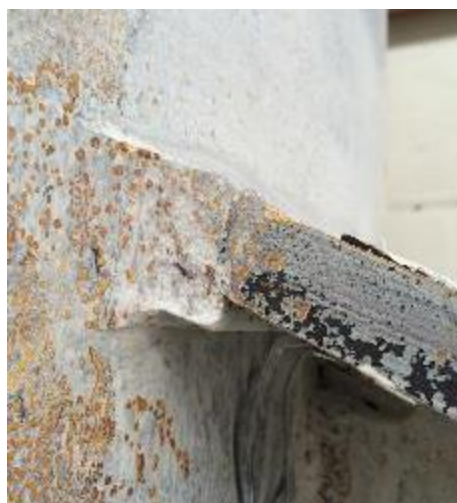
(d) Beam Top Flange CJP Weld (Minor Crack)
