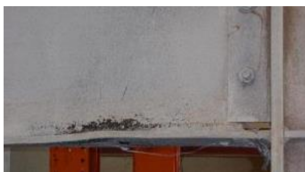
(d) Detail C (Beam Flange Local Buckling)
