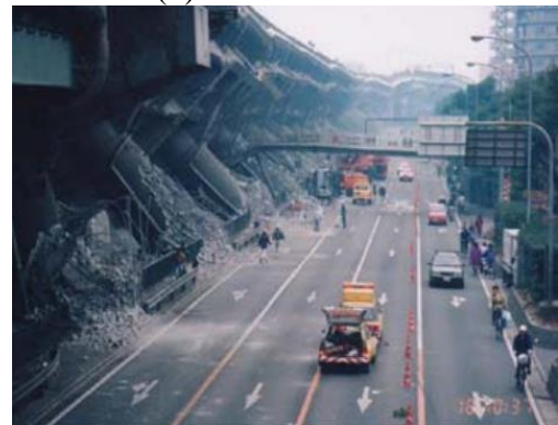
(d) Column flexural failure
