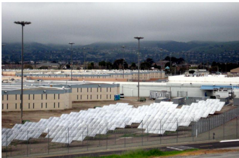
图 4: 斯塔瑞特监狱近照： 地面安装跟踪式太阳能光伏居前、电池和燃料电池居后
