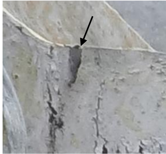
(b) Weld Tear
