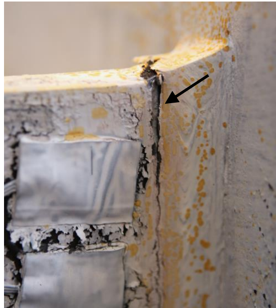
(b) Weld Tear
